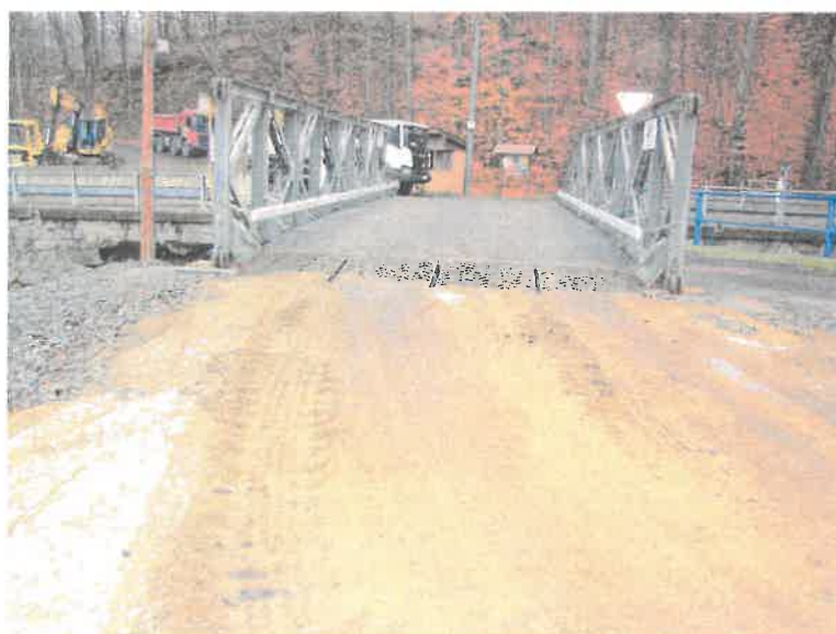
Pohled na MP proti směru staničení k sil. I/60 - absence SDZ DZ viz. text 1. HPM
