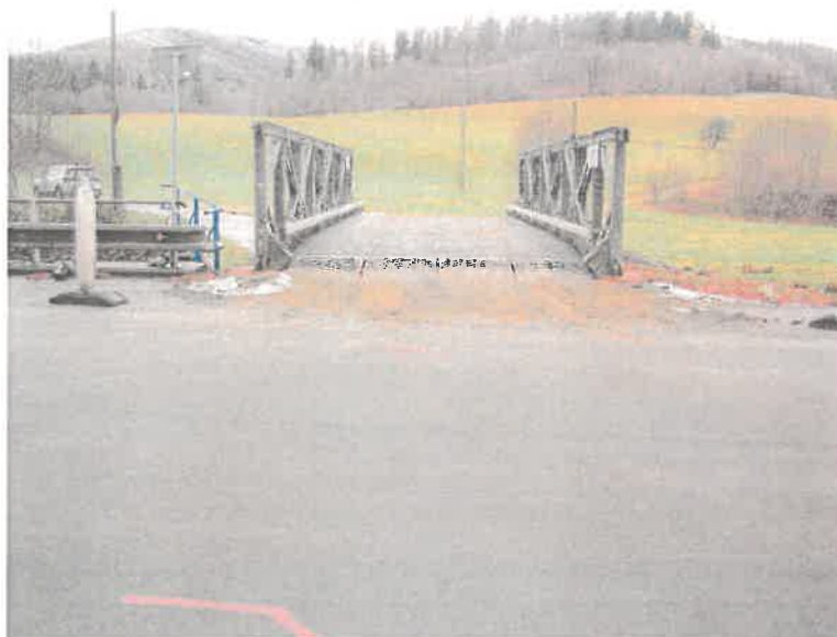
Pohled na MP ve směru staničení od sil. I/60- absence SDZ DZ viz text 1. HPM
