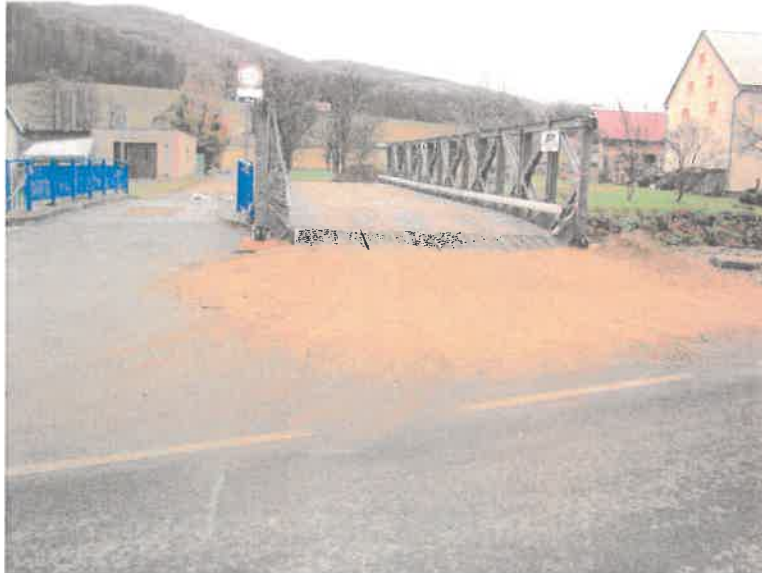
Pohled na MP ve směru staničení od sil. I/60 – absence SDZ DZ viz text 1. HPM
