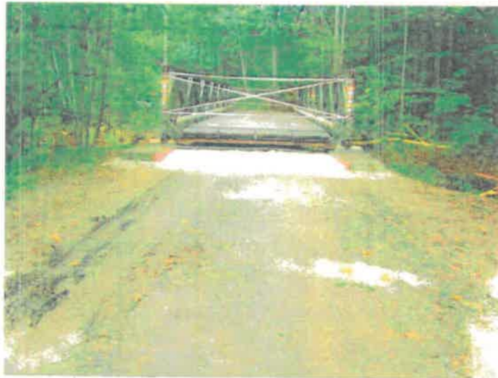
Pohled na MP proti směru staničení - absence SDZ DZ viz. text 1. HPM a rampovitého nájezdu na most
