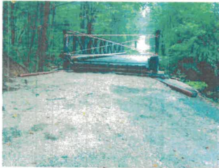
Pohled na mostní provizorium ve směru staničení - absence SDZ DZ viz text 1.HPM a rampovitého nájezdu na most
