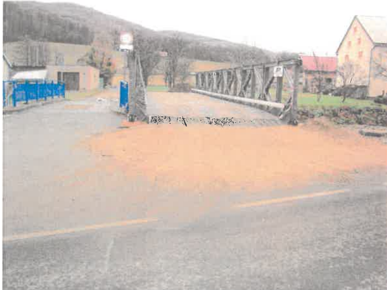
Pohled na MP ve směru staničení od sil. I/60 – absence SDZ DZ viz text 1. HPM
