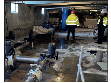
Armaturní komora rekonstruované ÚV Adolfovice. Foto: VaK Jesenicka
