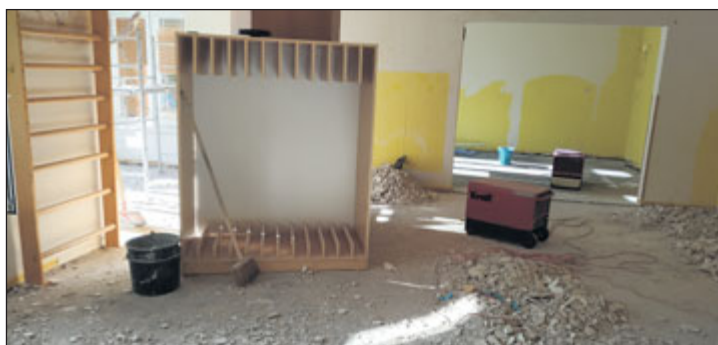
Havárie s vodou vyřadila školku z provozu na více než dva měsíce.
