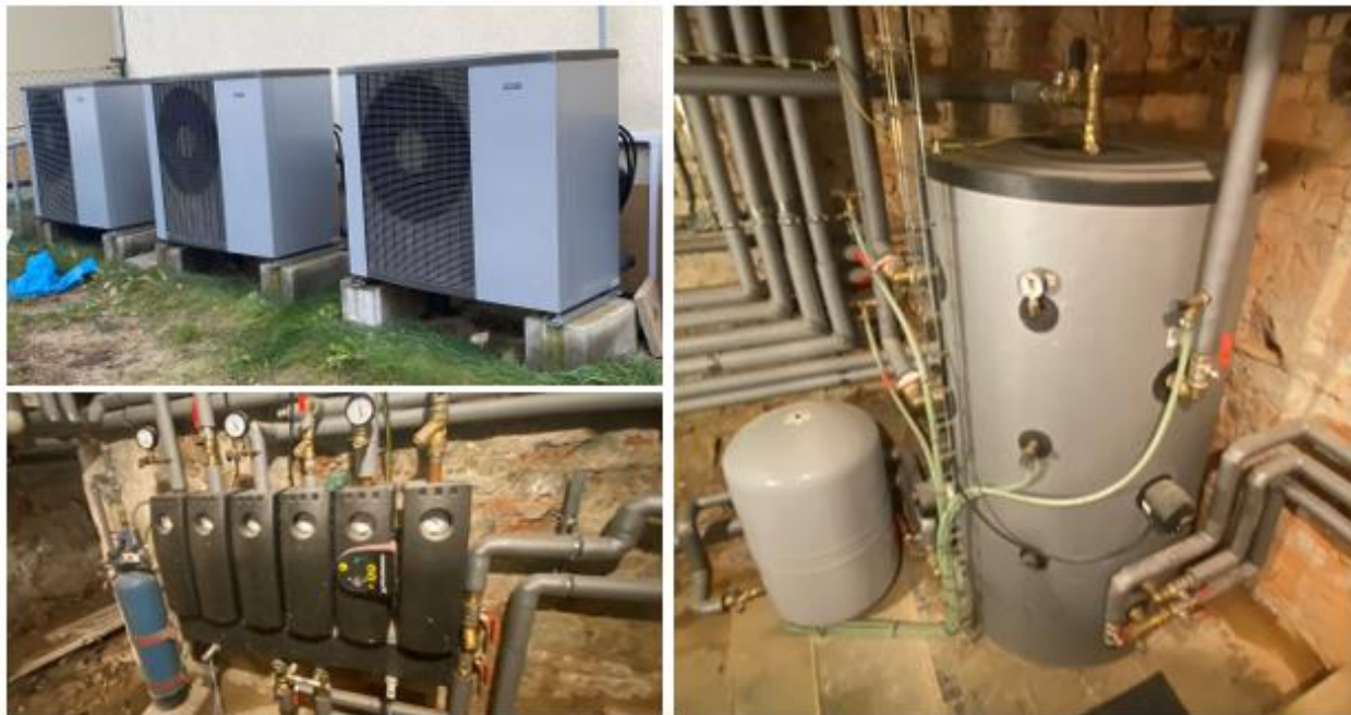
Obrázek 12: Tři tepelná čerpadla země-vzduch zásobující teplem budovu
