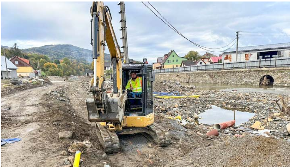
Práce na odklizení škod po povodni. Foto: archiv VaK Jesenicka
